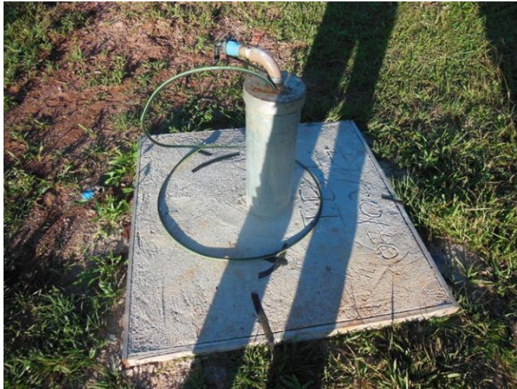
Imagem 04: Modelo de laje de proteção em concreto e coluna de revestimento e tampa protetora.
